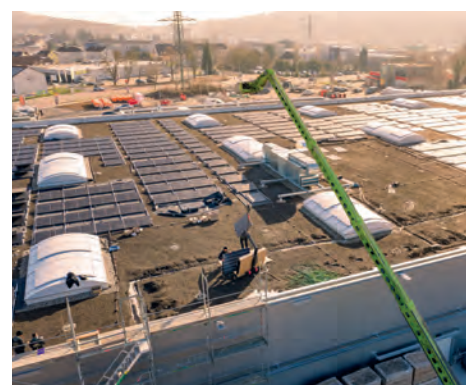
Photovoltaik im Großformat: Die installierte PV-Anlage auf dem Neubau in Mühlacker liefert saubere Energie und zeigt, wie wichtig professionelle Planung, fachgerechte Umsetzung und ein hohes Maß an Teamarbeit sind.
